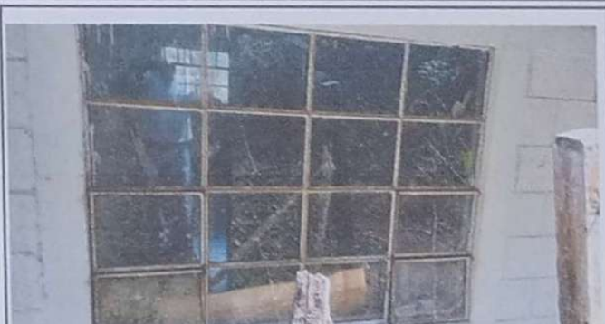
Foto 2: Se colocará balcones para las dos ventanas de la dirección ya que corre peligro por los documentos y enseres que se resguarda ahí.
