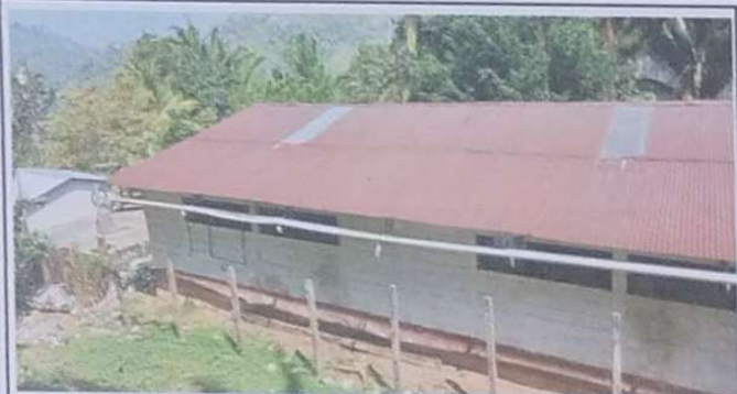
Foto 1: Techo del Centro Educativo en mal estado, se cambiará por estructuras metálicas ya que la madera se esta pudriendo y corre peligro para los niños.
